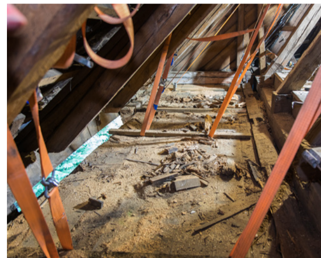
Postępująca degradacja więźby mogła doprowadzić do zawalenia się dachu
